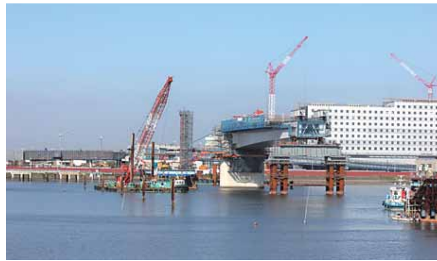
20年度完成に向け工事が進む羽田空港とキングスカイフロントを結ぶ連絡橋。人材や技術の国際交流が加速する
